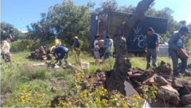
FOTOGRAFÍA 8. Jornadas de tequio para la construcción de la pileta comunitaria en el cerro de Chiconauhtla, Estado de México.
