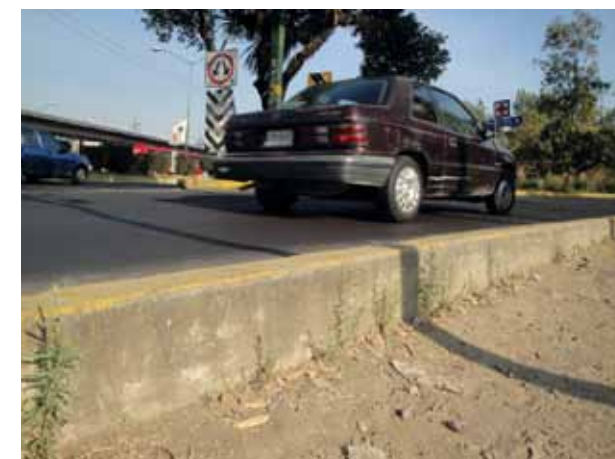
Obstáculo que dificulta la accesibilidad peatonal.
